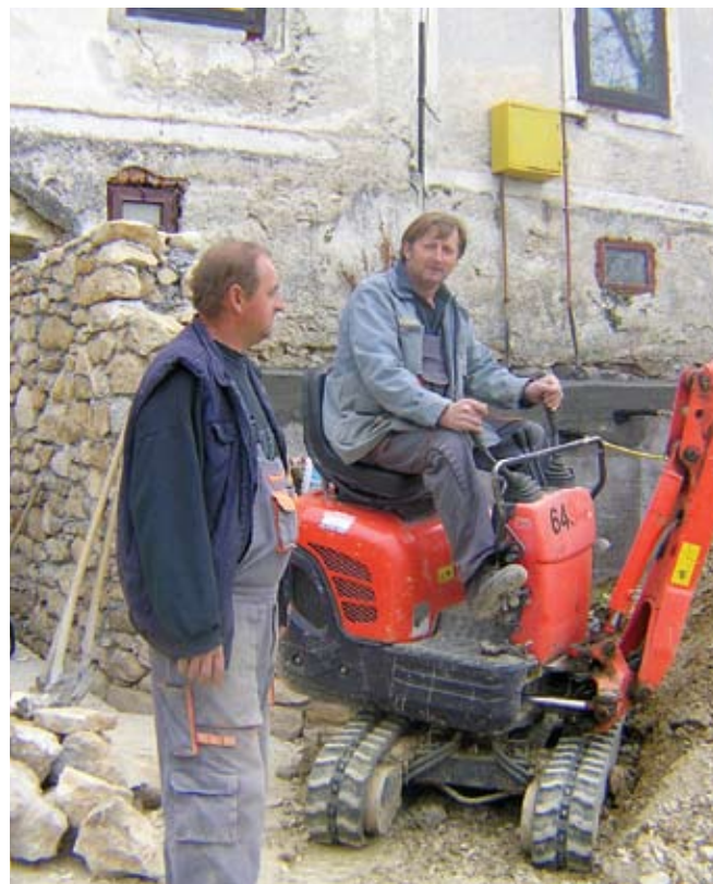
Uz zapadnu stranu Župnog dvora treba betonskim zidom osigurati zgradu.
