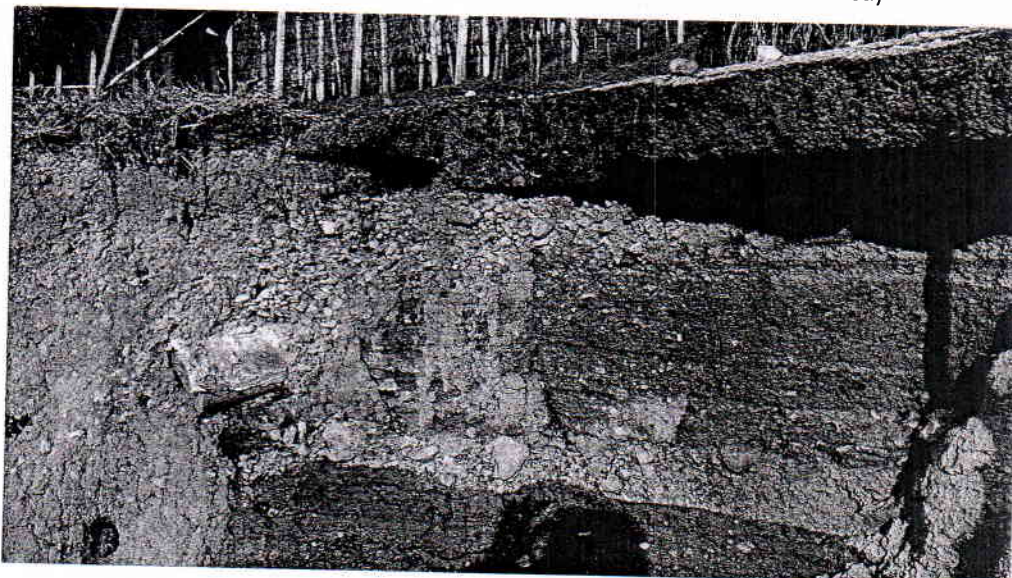
Slika 7. Izlaz (zaštopane) cijevi u tijelo klizišta. Uloga ove cijevi nesumnjivo je bila ododnja voda s druge strane ceste (i zdenca)
