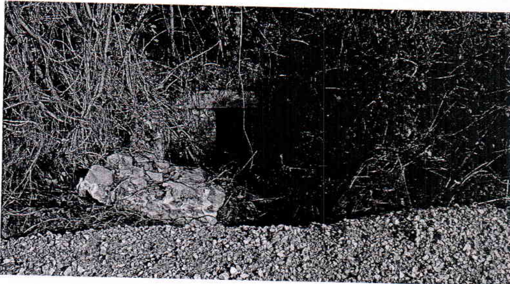
Slika 6. Zdenac uz pribriježnu stranu ceste koji je na dan obilaska klizišta (21.1.2018.) bio ispunjen vodom (razina vode je manje od 1 m od ruba zdenca)
